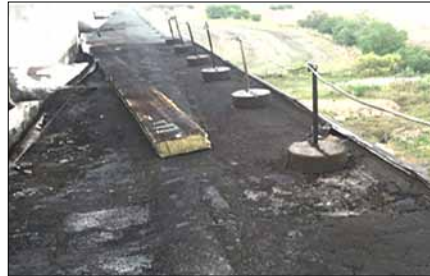
Obr. 2. Požár střešní krytiny vzniklý nedodržením dostatečné vzdálenosti
