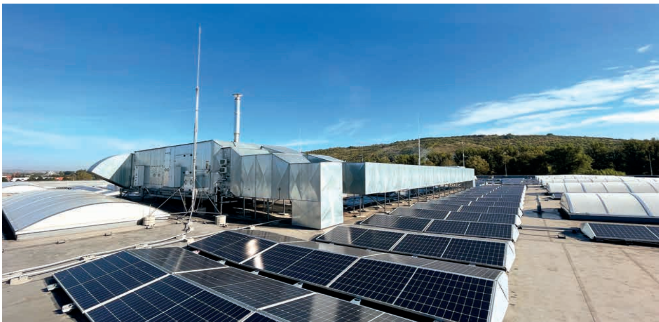
FV panely a klimatizace na střeše haly
