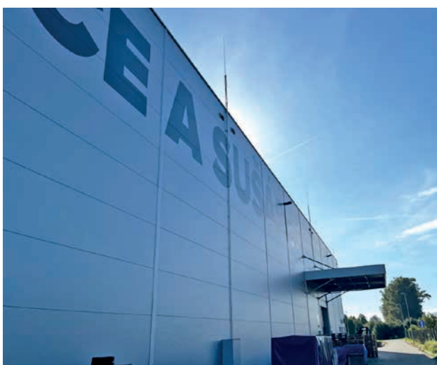
Svody vodiče HVI instalované na vnějším plášti na budovy
