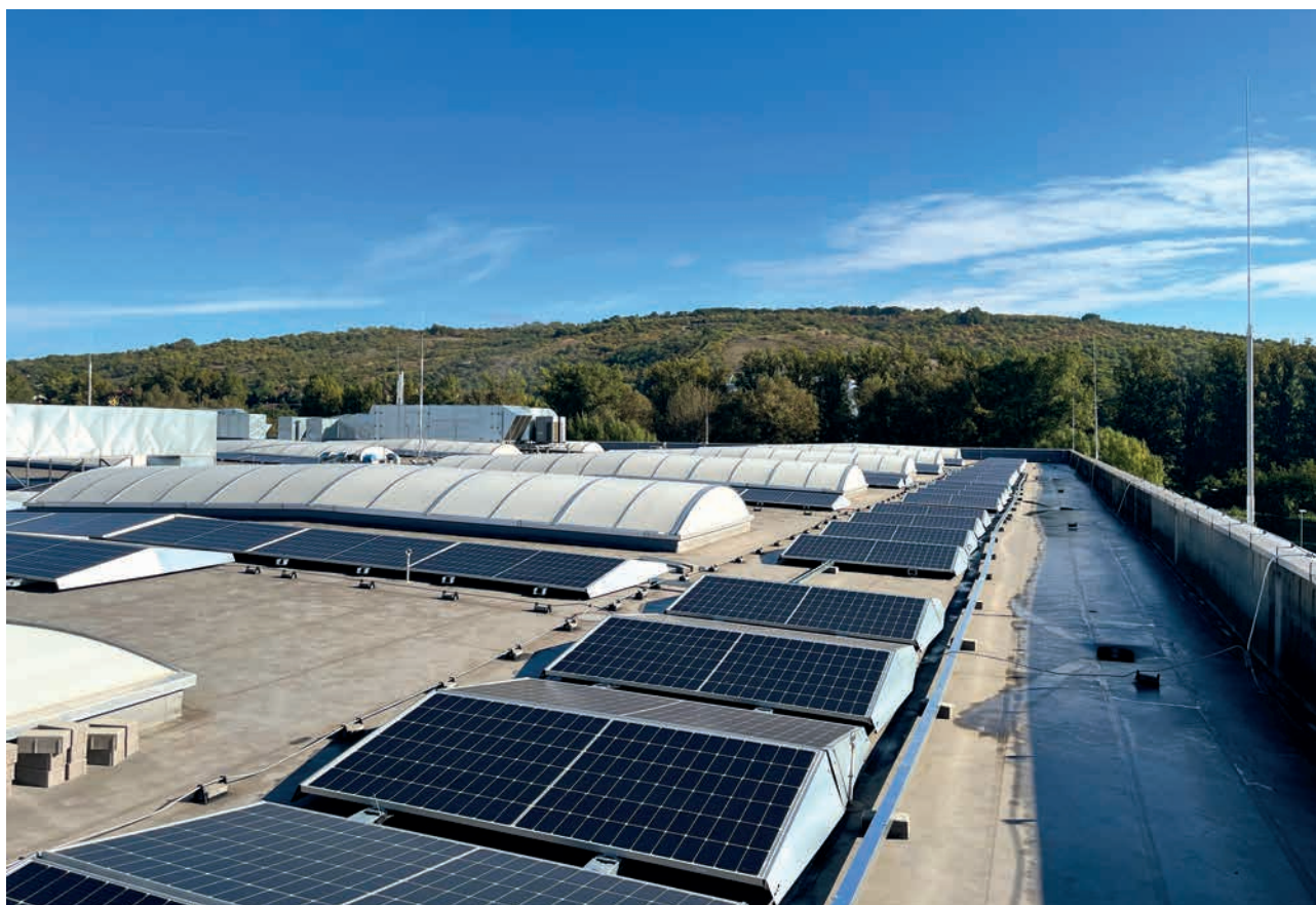
FV panely v ochranné zóně LPZ 0
