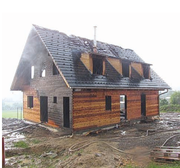
Obr. 2 Pohled na vyhořelou dřevostavbu
