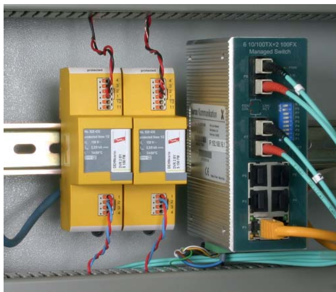
Ochrana reproduktorových vývodů u zařízení hlasové výstrahy
