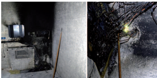
■ Obr. 1 Škody na fotovoltaických panelech vyvolané přímým úderem blesku [1]
