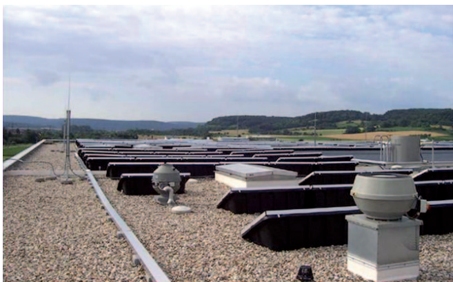
■ Obr. 4 Použití vodiče HVI® light – jímací soustava a FV systémy na střeše výrobní haly
