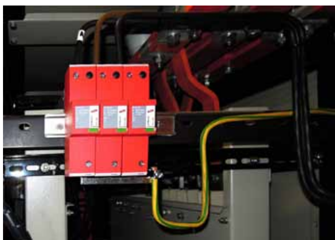
Obr. 7 Instalace DEHNvenCI v hlavním rozváděči objektu
