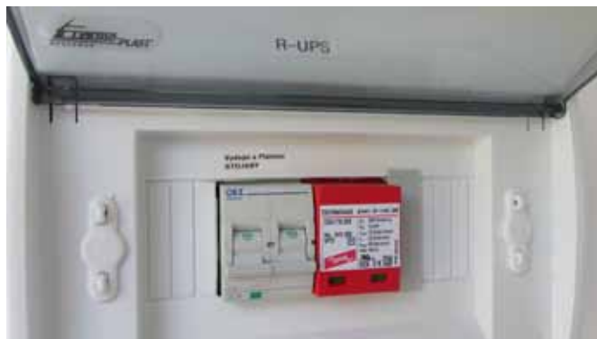
Obr. 8 DEHNshield v podružném rozváděči objektu
