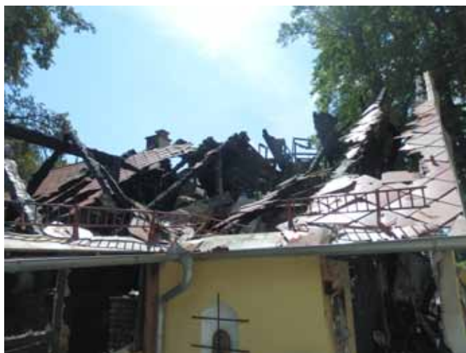
Obr. 1 Vyhořelá část budovy
