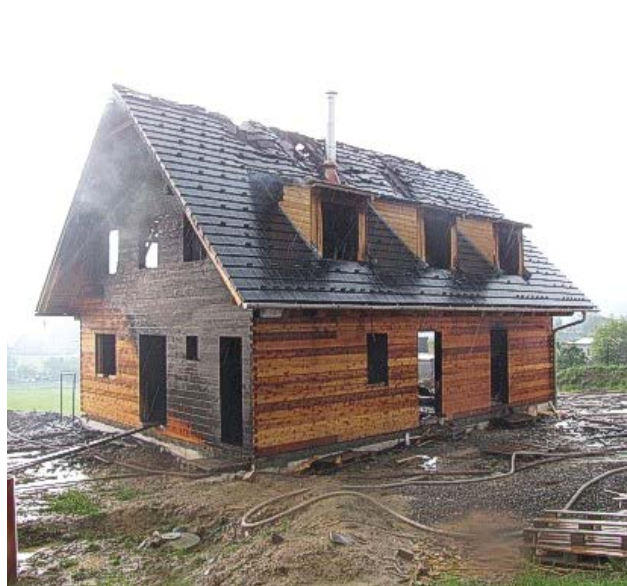
Obr. 2 Pohled na vyhořelou dřevostavbu
