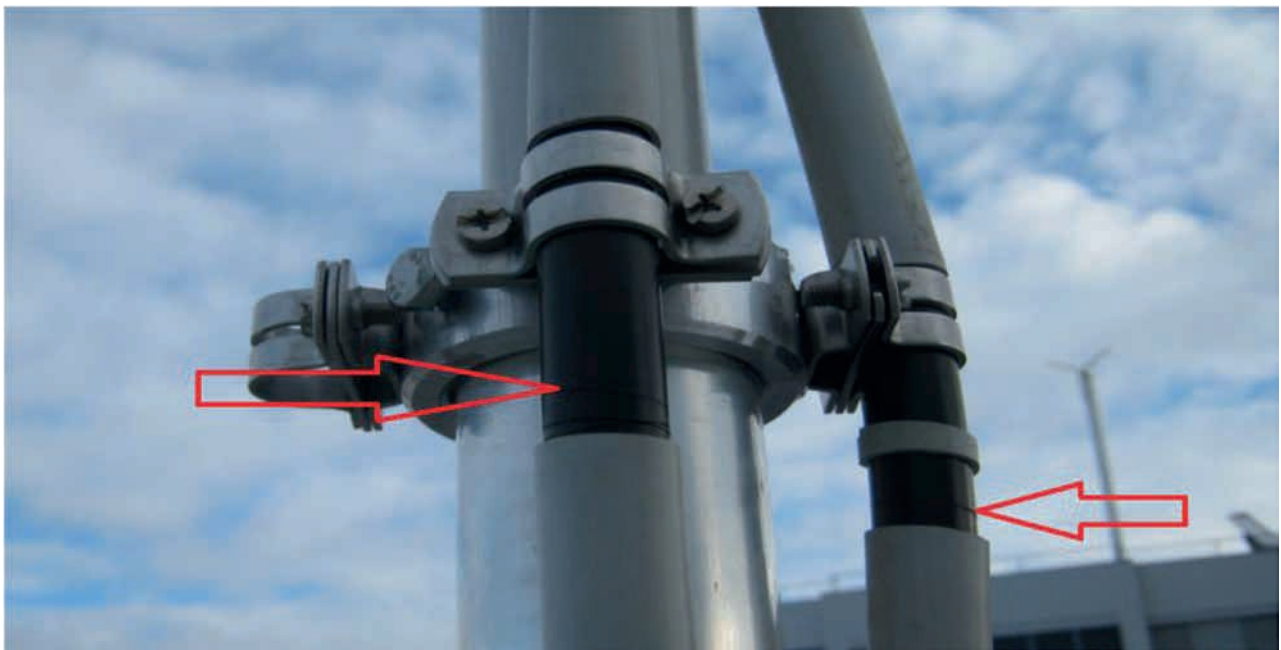
Ukázka poškození vodiče během instalace
