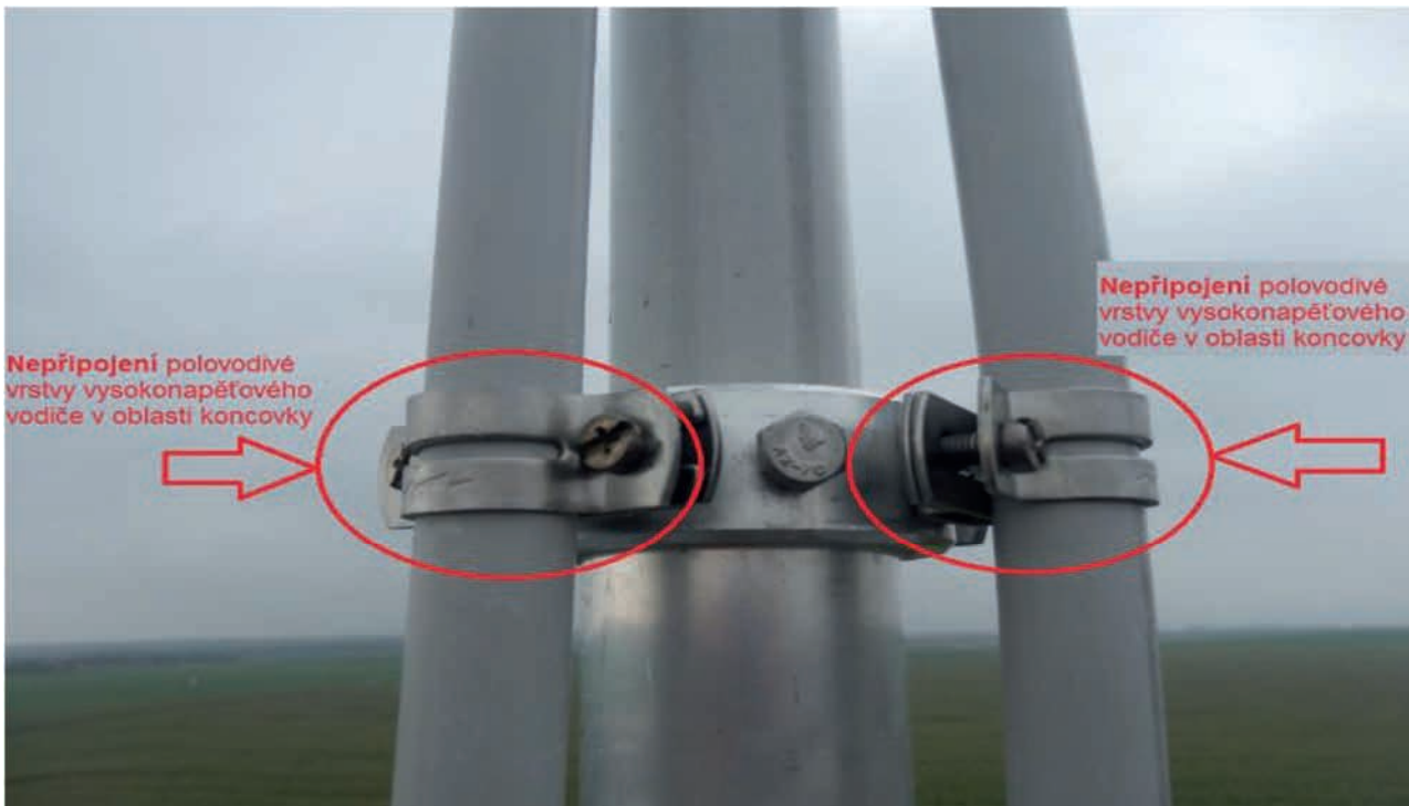
Ukázka chybné instalace – nedodržení montážního návodu
