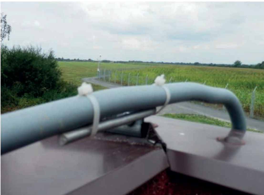
Ukázka nevhodného kotvení vodiče ke stavbě
