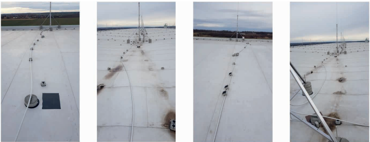
Ukázka poškození jímací soustavy po silném větru
