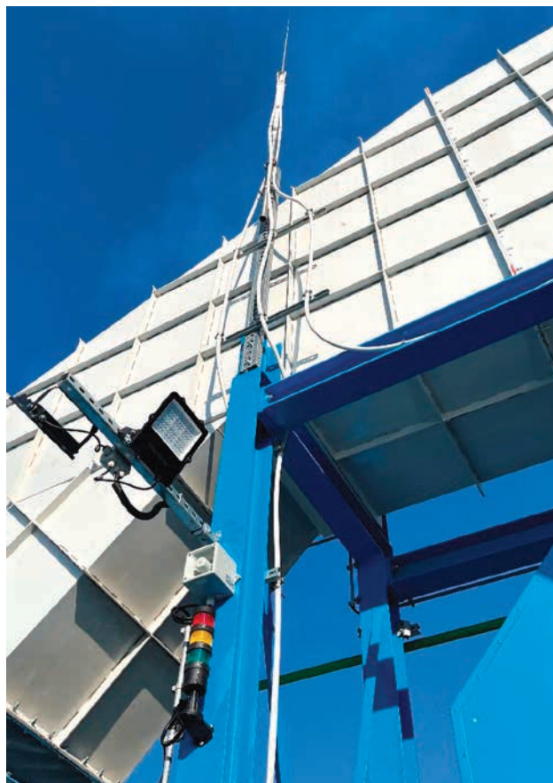
Paralelní svody a podpůrná trubka
