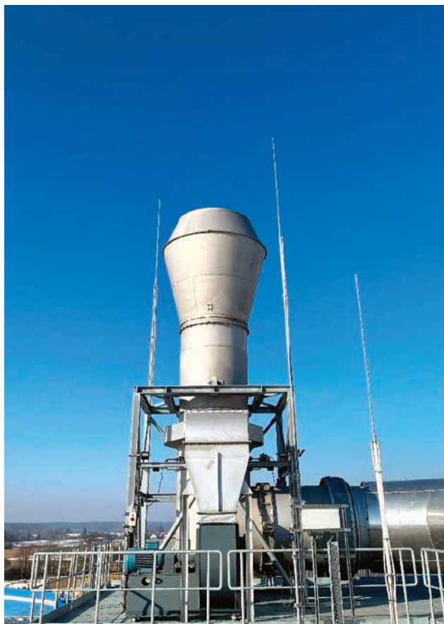
Podpůrné trubky umístěné na technologiích
