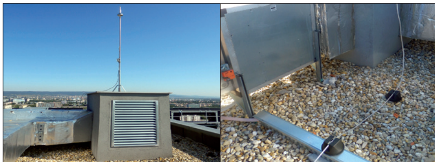
Obr. 3. Nedodržení dostatečné vzdálenosti mezi svodem a kovovou konstrukcí na střeše objektu
