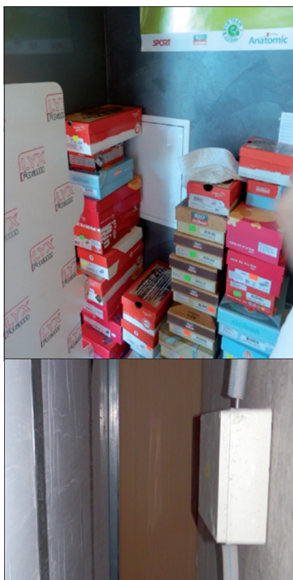
Obr. 6. Nepřístupné zkušební svorky a skryté svody umístěné v hořlavých trubkách
