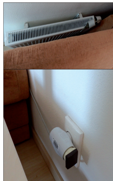
Obr. 5. Nedodržení dostatečné vzdálenosti mezi svodem, kovovým topením a elektroinstalací bytů
