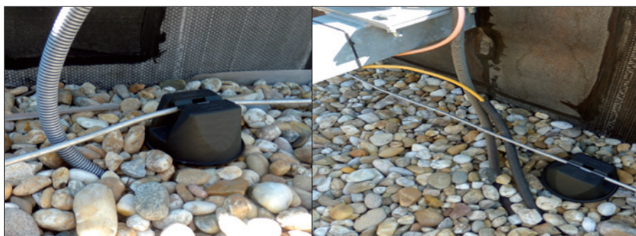
Obr. 4. Skrytý svod umístěný v hořlavé instalační trubce – přeskok blesku na vnitřní instalace
