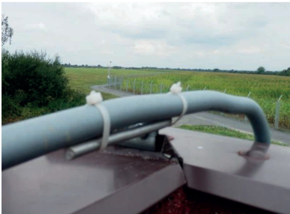
Ukázka nevhodného kotvení vodiče ke stavbě
