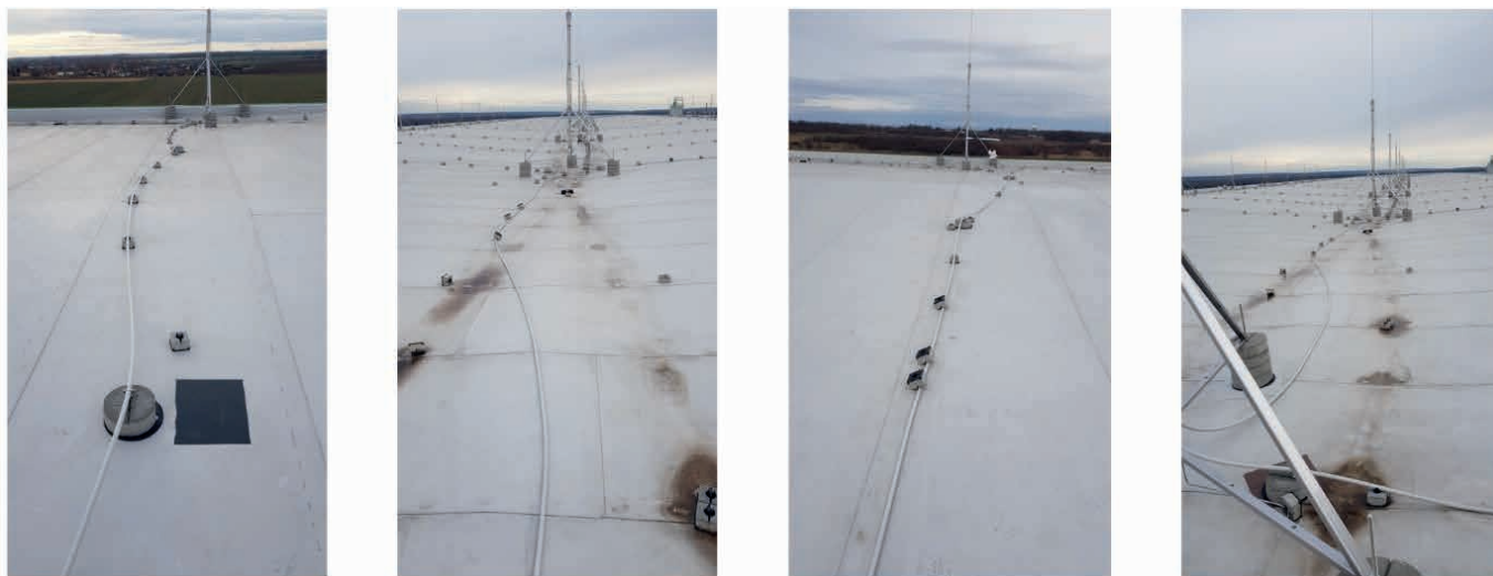
Ukázka poškození jímací soustavy po silném větru
