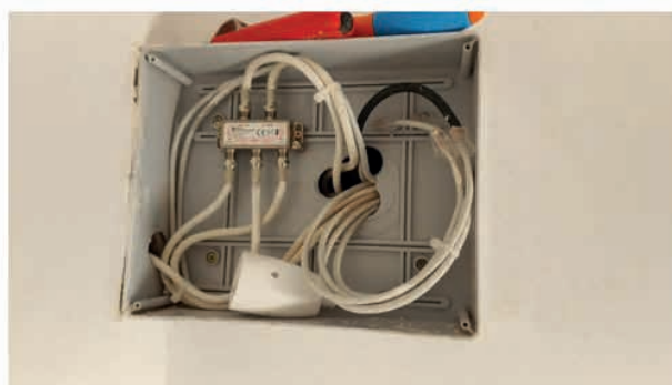
Ukázka nevhodného provedení
