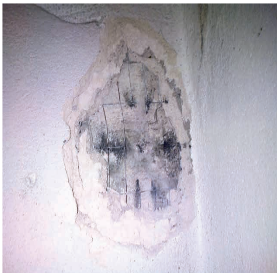
Škody na stěně budovy s armovanými stěnami
