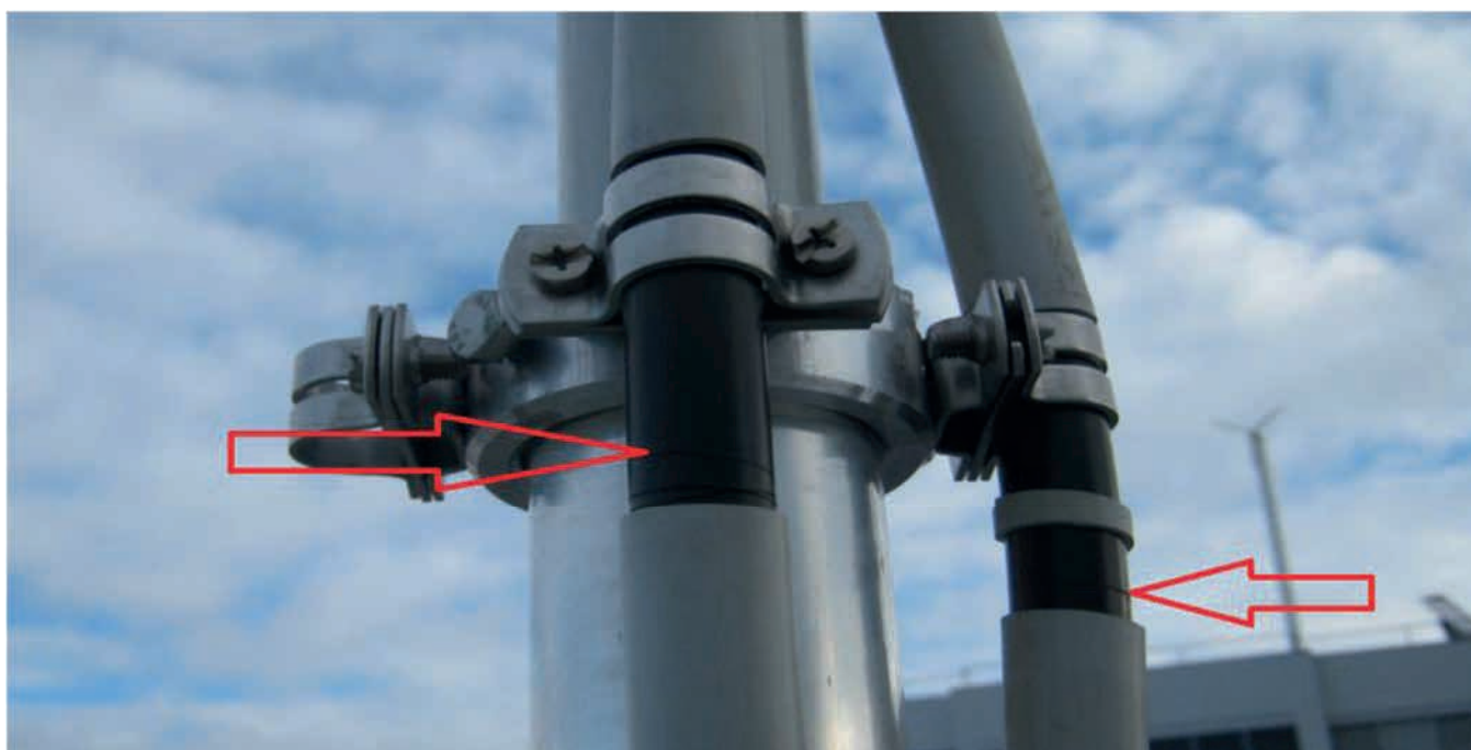
Ukázka poškození vodiče během instalace
