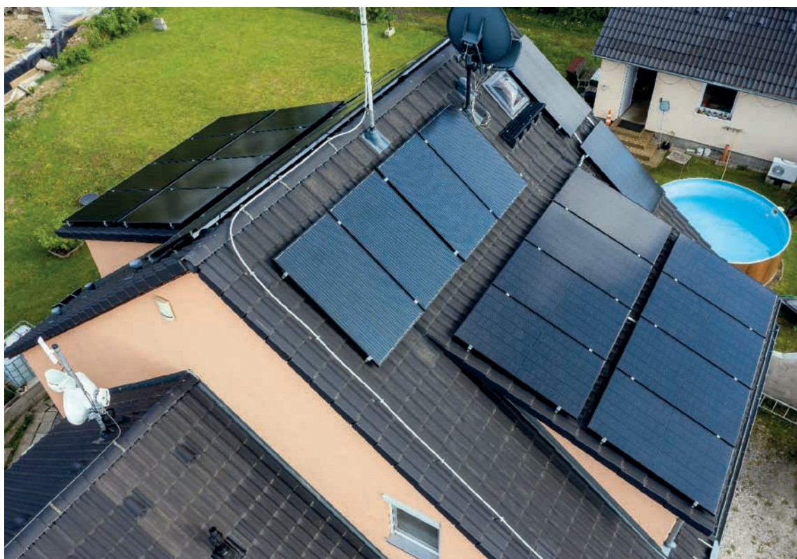
Obrázek 6 – Vedení HVI po střeše
