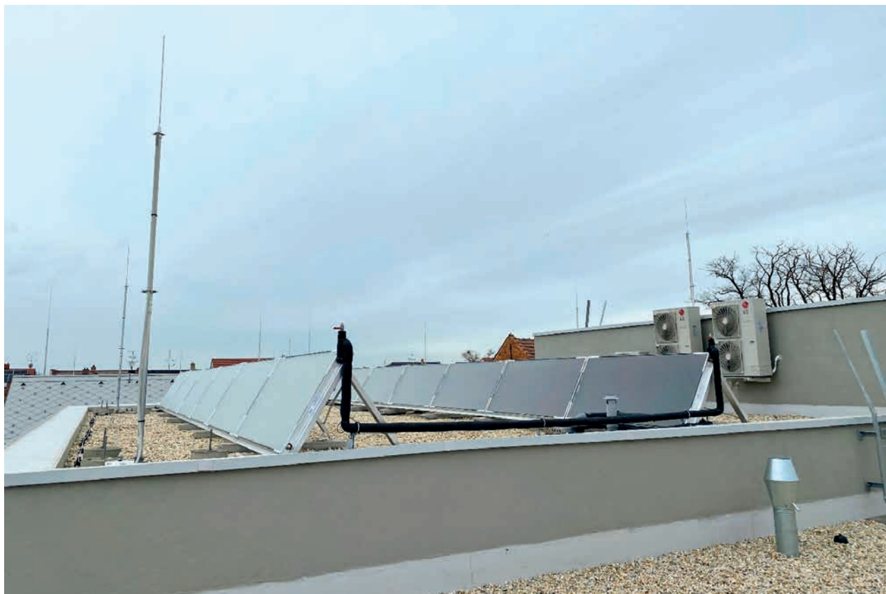
Obrázek 3 – Detail zařízení na střeše – bezpečně v ochranném prostoru
