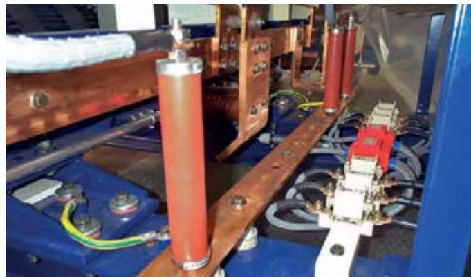
Obrázek 9.16.9 Svodič pro vn DEHNmid instalovaný na transformátoru větrné elektrárny
