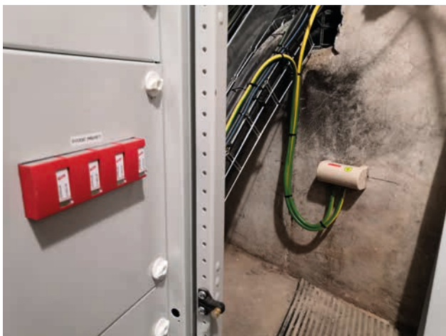
Hlavní rozváděč Svodič SPD T1+T2+T3 (jiskřiště, 100 kA, vlny 10/350)
