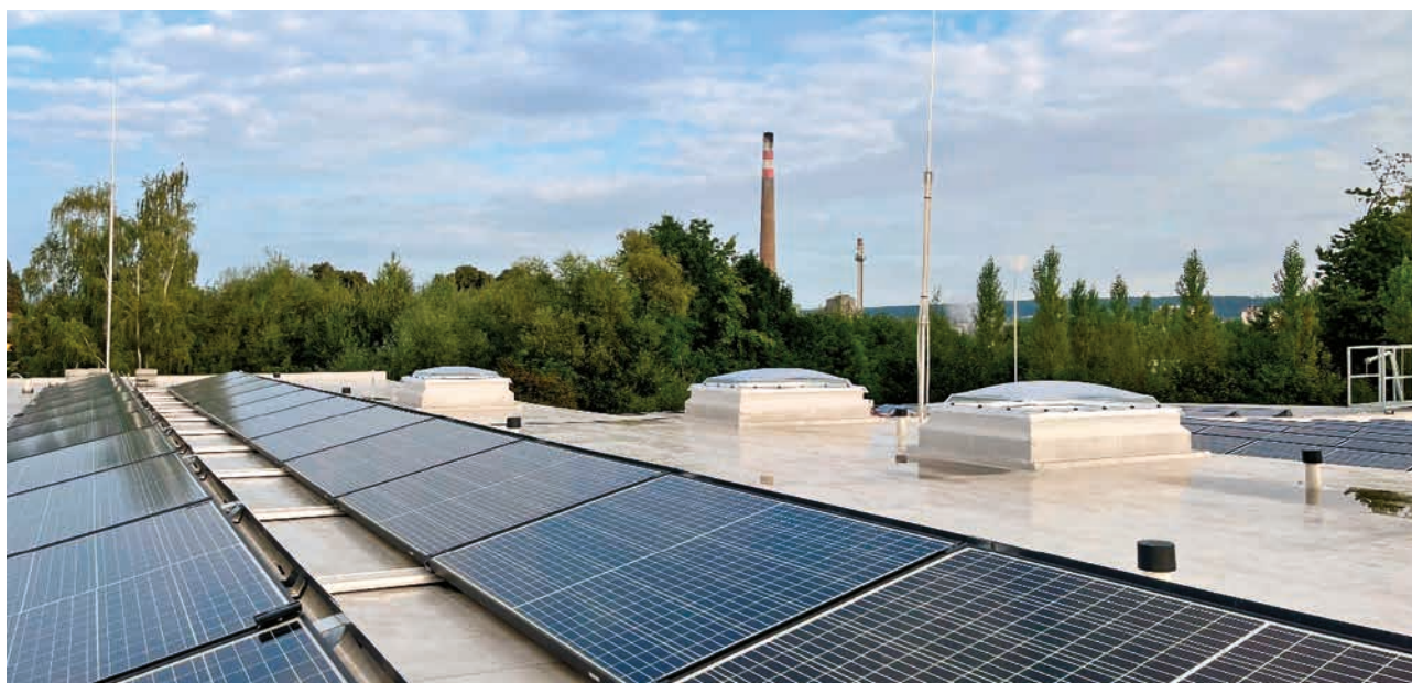
Obr. 3. Provedení jímací soustavy
