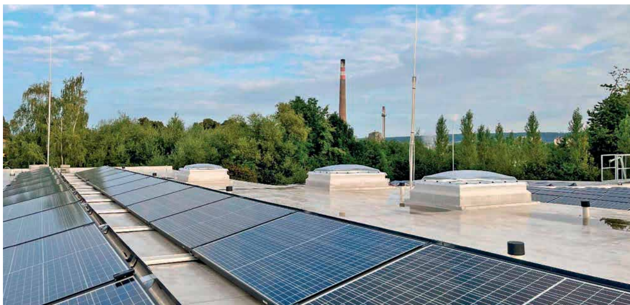
Obr. 3. Provedení jímací soustavy
