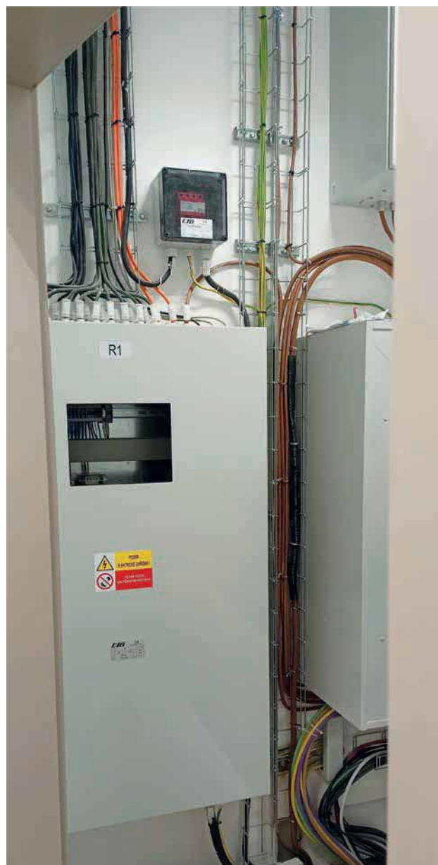
Obr. 10. Svodič přepětí umístěný na napájecím vedení pro rozvaděče
