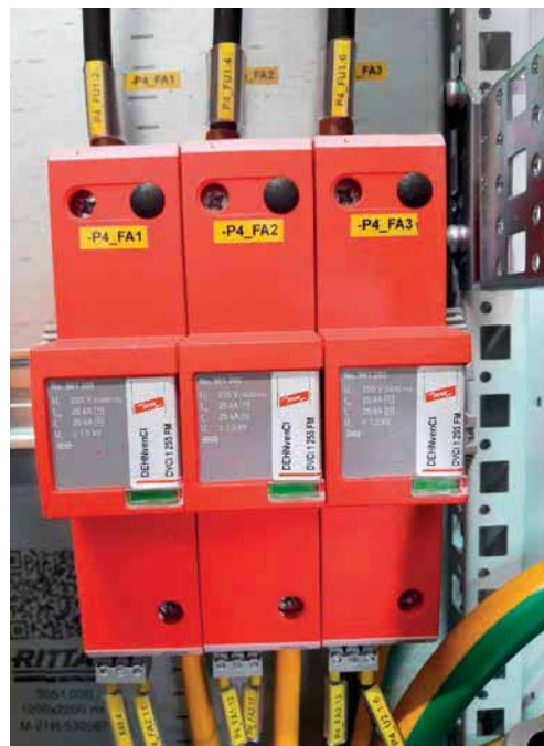
Obr. 11. Svodič bleskových proudů a přepětí instalovaný na vstupu vedení do objektu
