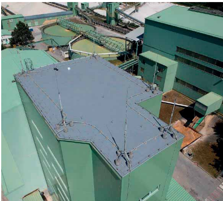
Obr. 9. Provedení jímací soustavy
