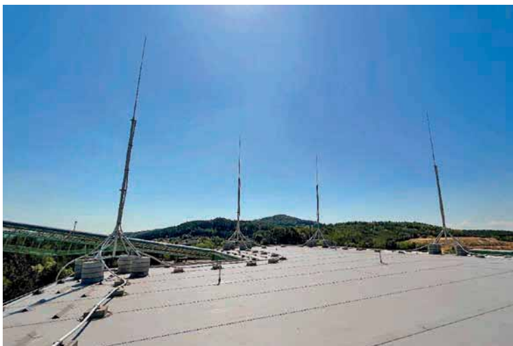
Obr. 10. Provedení jímací soustavy
