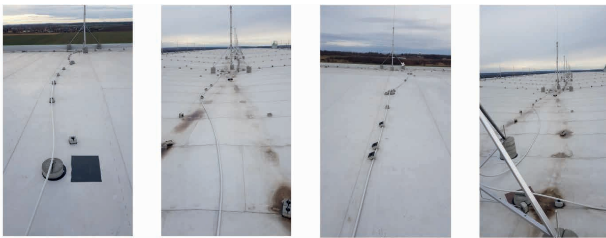
Ukázka poškození jímací soustavy po silném větru
