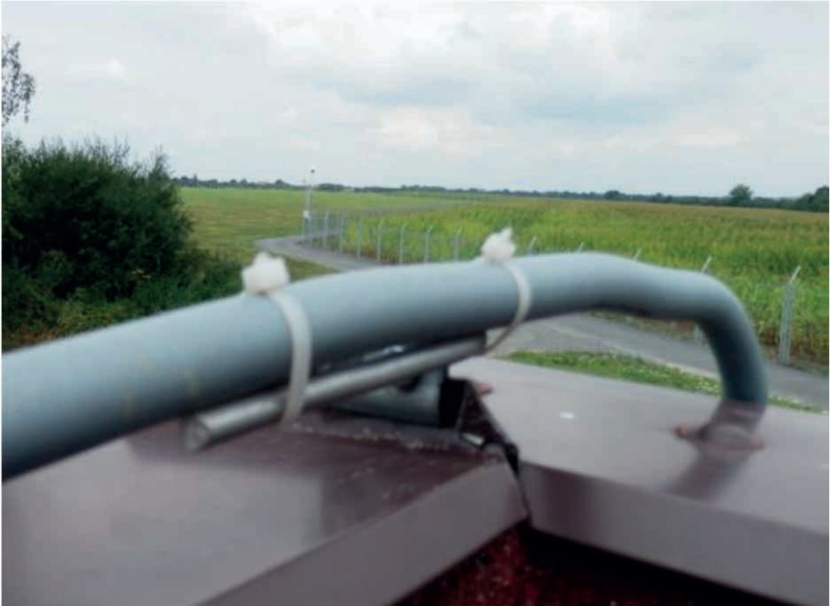
Ukázka nevhodného kotvení vodiče ke stavbě
