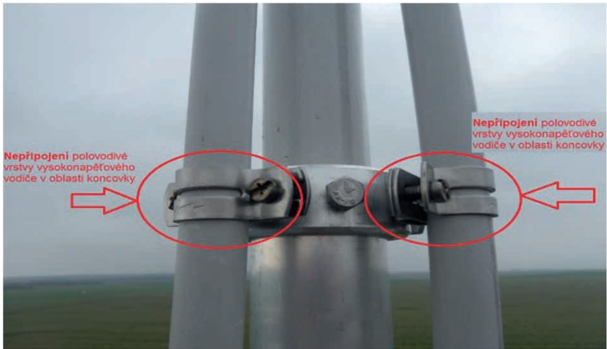
Ukázka chybné instalace – nedodržení montážního návodu
