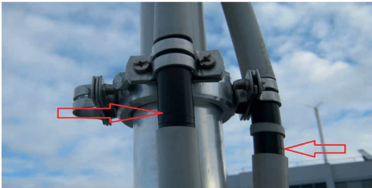
Ukázka poškození vodiče během instalace
