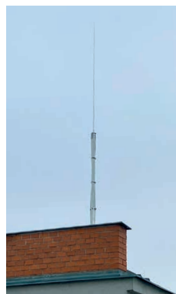
Detail podpůrné trubky s 2,5 m jímací tyčí
